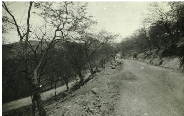
«Strada Massaua + Asmara – Dongollo» dall'album fotografico «Lavori per la costruzione della strada e ponti. (Ghinda, Dogali, Saati, Moncullo, Sabarguma, Otumlo. [1935-1937]» (BNCR fototeca online IsIAO EREDITA_7_C_I_II)
