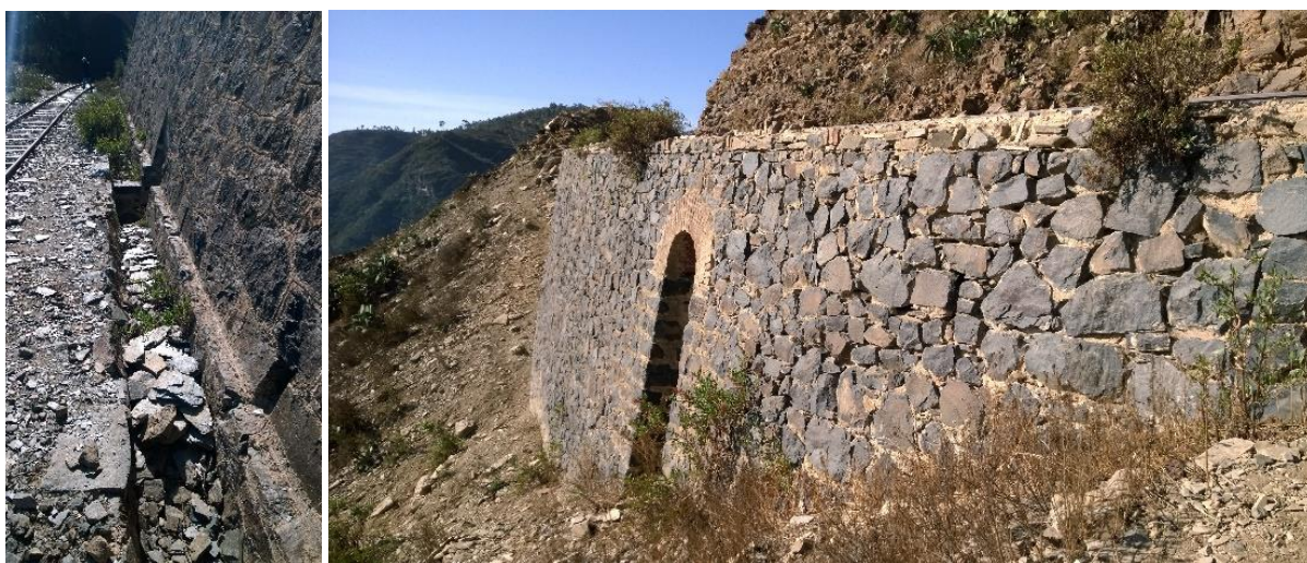
Il fosso di guardia e un tombino lungo il tratto ferroviario nei pressi delle Porte del Diavolo (foto 2018).
