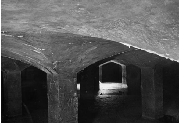
Interno del vano cisterna del serbatoio ferroviario di Embatcalla ("Ferrovia Massua-Asmara-Keren-Agordat-Biscia 1939. Album" tratto da www.ferroviaeritrea.it a cura di Stefano Pettini).
