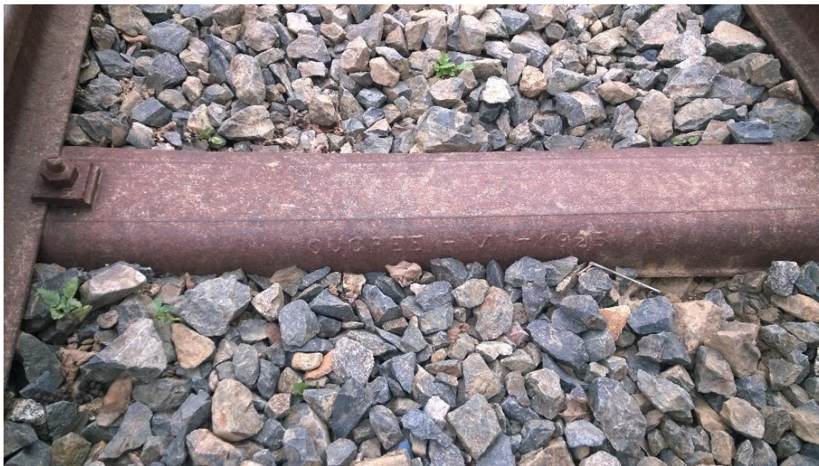
Stazione di Embatcalla: il ballast affiora tra le traverse (foto 2018)
