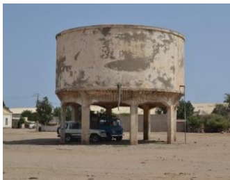
Serbatoio in cemento armato alla stazione di Campo Marte (foto 2018)
