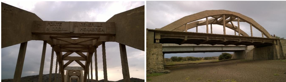
Alcuni dettagli dei ponti in cemento armato ad arco a via inferiore tra Moncullo e Sabarguma (foto 2018).
