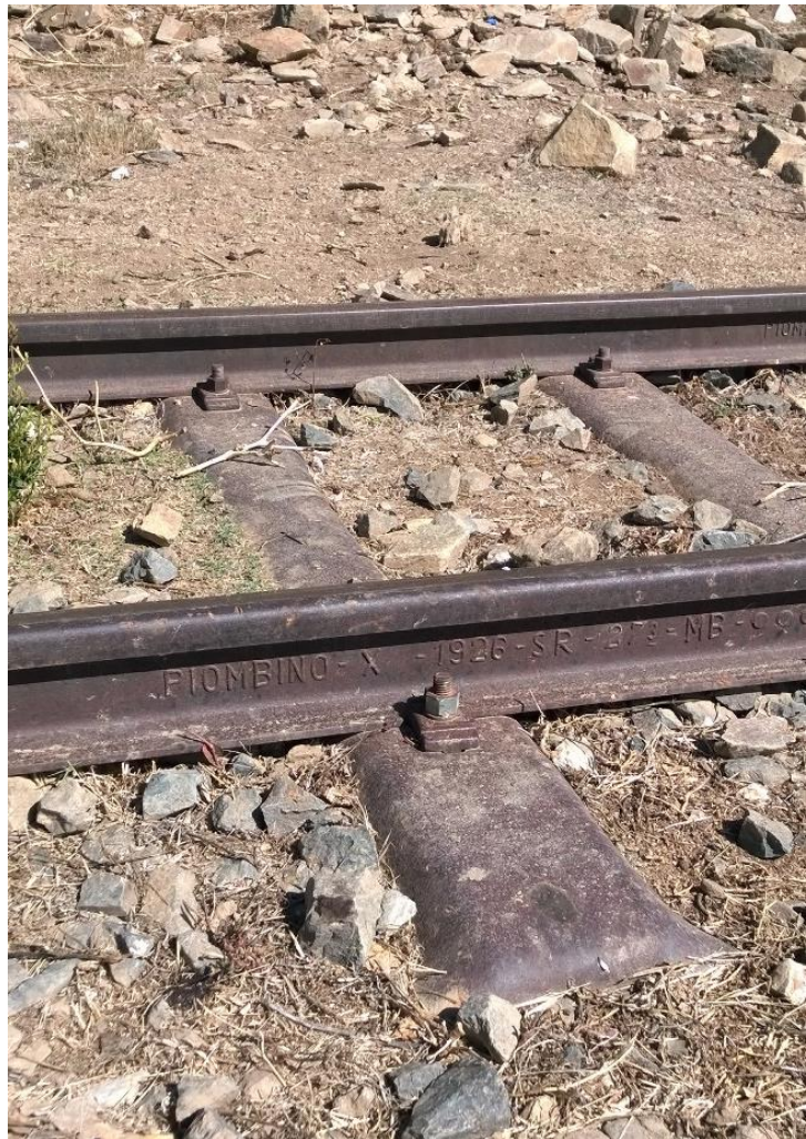
Bulloncini e piastrine di fissaggio della rotaia alle traversine (foto 2018)
