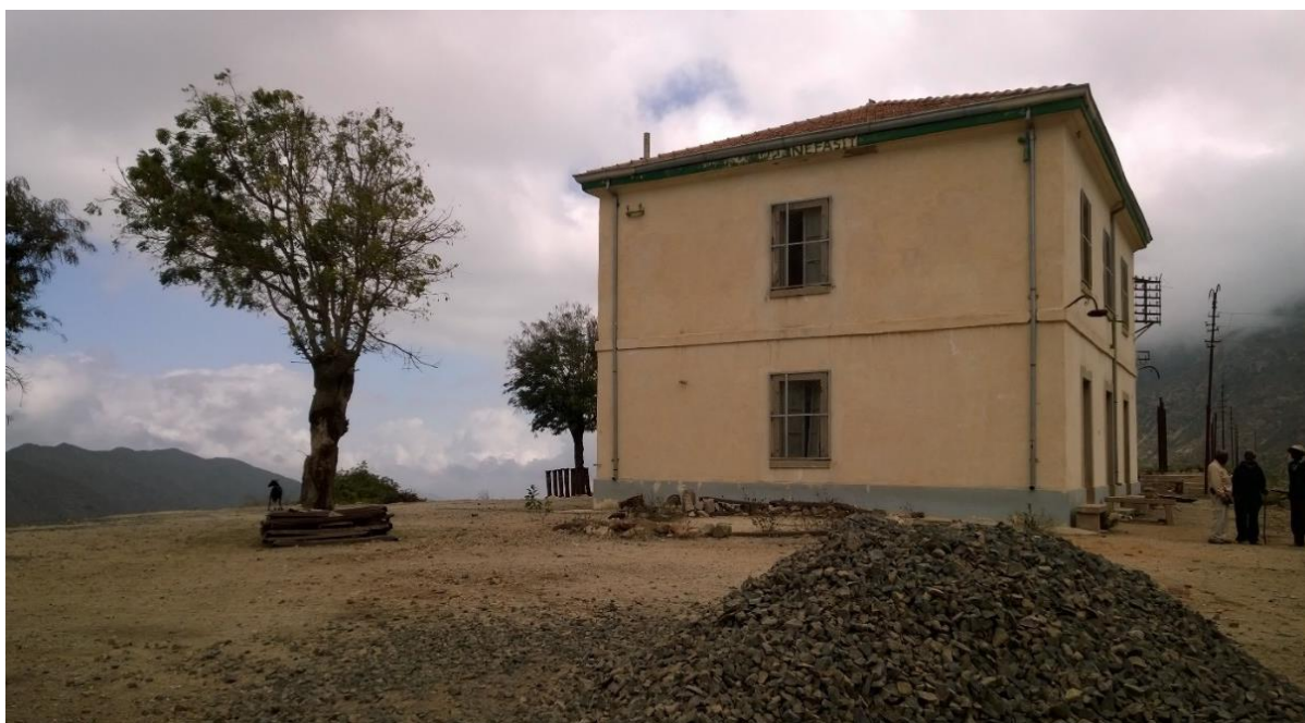
Il fabbricato viaggiatori della stazione ferroviaria di Nefasit è stato sottoposto a interventi sulle facciate e sulla copertura (foto 2018).
