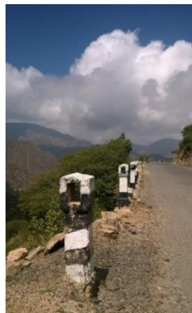
I montanti del sistema di protezione a bordo strada rimasti in loco (foto 2018).
