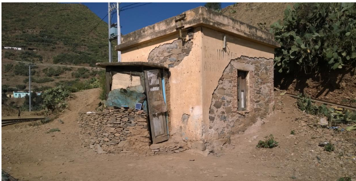
Casello ferroviario alla progressiva chilometrica 110+400, esempio di edificio in uso ma mai sottoposto a interventi di recupero (foto 2018).
