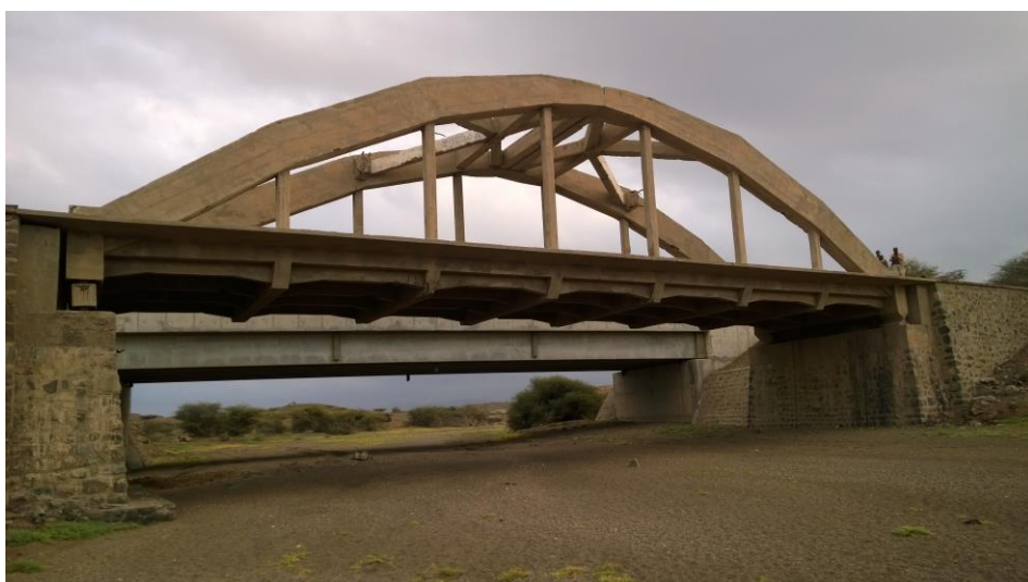
Il ponte sul Uadi Boo o di Dogali 2, non utilizzabile, è stato affinato da un nuovo ponte realizzato nel 2004 nell'ambito del progetto JICA (foto 2018).
