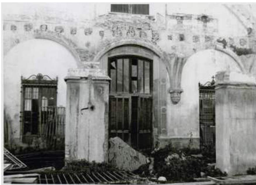
Imagen 42.- Hospital Provincial: desmonte del porche de entrada, ca. 1960. Fuente: A.D.P.V. / Fototeca Histórica. Hospital General / 09339
