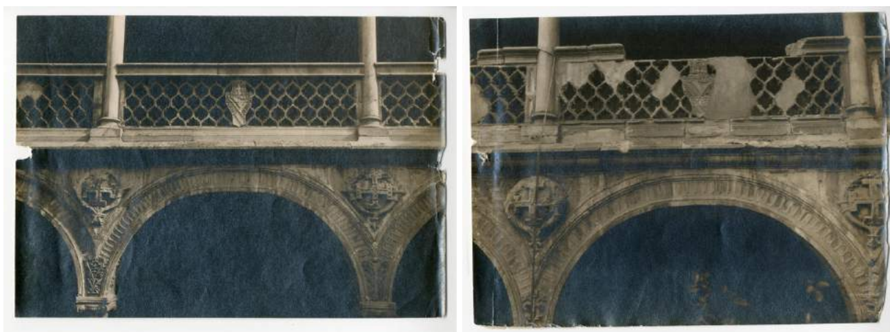
Imagen 34 y 35- Proyecto de obras de cantería para la restauración del patio principal, 1929. Fuente: A.G.A. Caja 31/04894 Exp. 014
