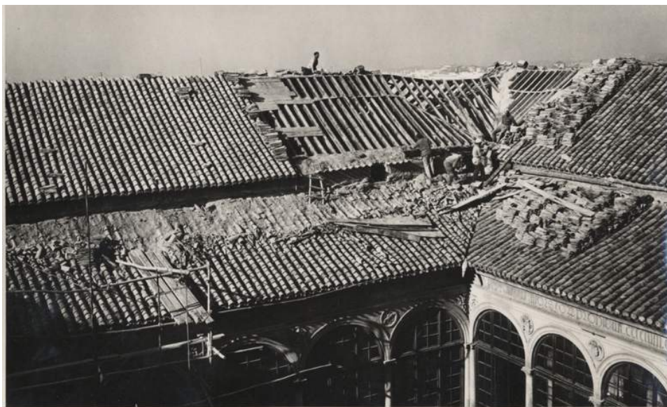
Imagen 11.- Hospital Real de Granada. Estado de las Cubiertas en el Patio de la Capilla, 1962. Fuente: A.G.A. / 26-00248-003
