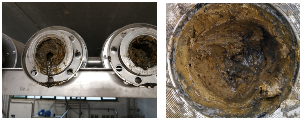
Figura 3.1: Accumulo di materiale lipidico sulla superficie delle tubazioni
