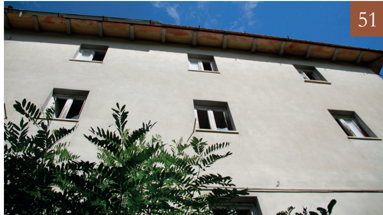
Codice ripresa: 51 Soggetto: Prospetto Sud Vista: Prospettica Data: 27/09/2019 Fotocamera: CANON EOS 500D Risoluzione: 350 dpi
