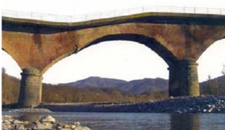
Figura 1.7. Dissesto di una arcata di un ponte sul fiume Scrivia in seguito ad una piena
