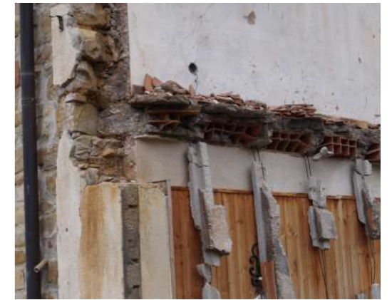
Foto 142 di Martina De Pasquale: 17 novembre 2019, dettaglio del crollo del solaio di un'abitazione.
