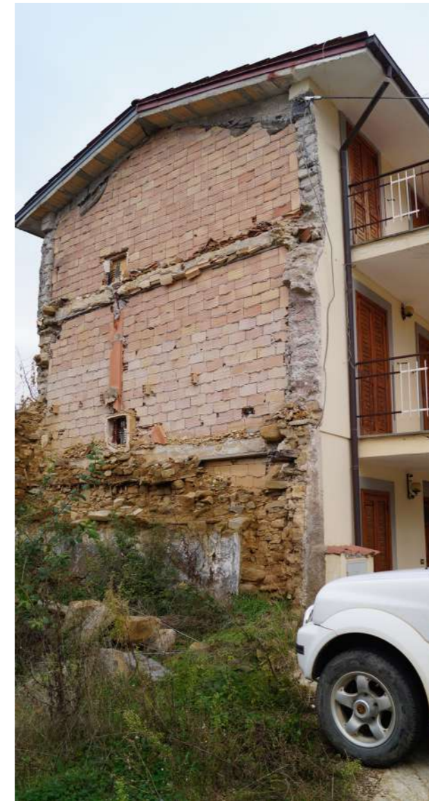
Foto 61 (in alto) e 62 (a sinistra) di Martina De Pasquale: 17 novembre 2019, edilizia residenziale gravemente danneggiata.
