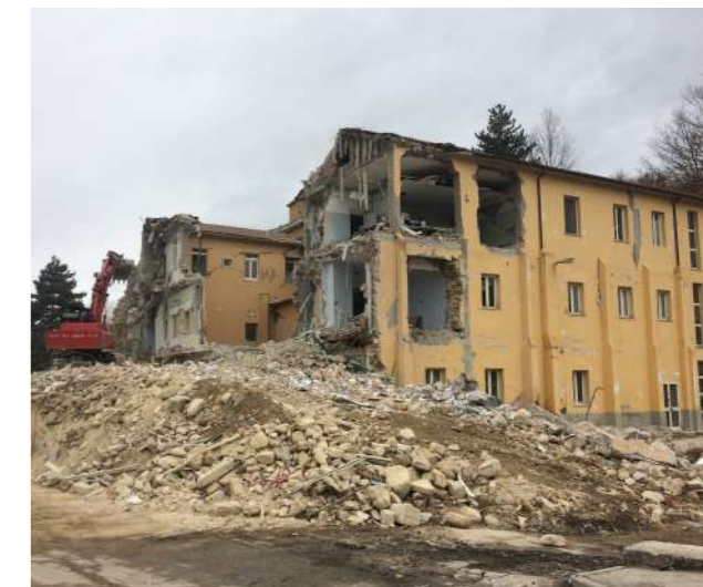
Foto 50 di Emma Moriconi: 28 febbraio 2017, pareti retrostanti interamente crollati.
