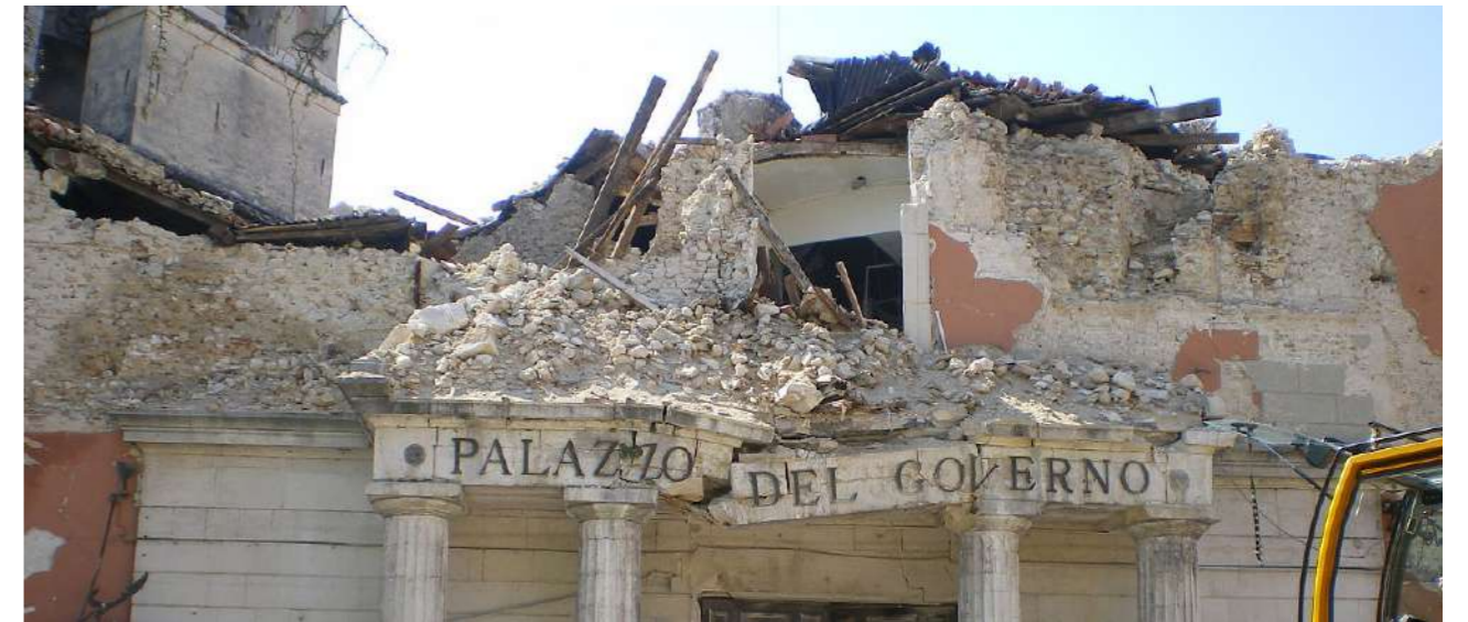
Foto 21: 2009, la Prefettura dell'Aquila dopo il sisma, uno dei simboli della distruzione (fonte: wikipedia).
