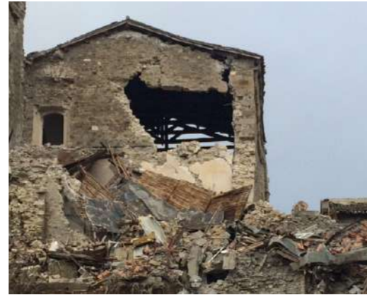
Foto 110 di Emma Moriconi: 9 settembre 2016, edilizia residenziale nei pressi del centro storico, gravemente danneggiata.
