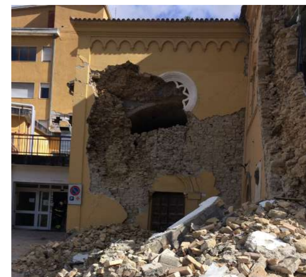
Foto 161 di Emma Moriconi: 2018, facciata principale crollata.
