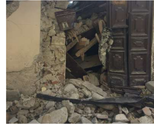
Foto 111 di Emma Moriconi: 27 marzo 2017, dettaglio portale crollato.
