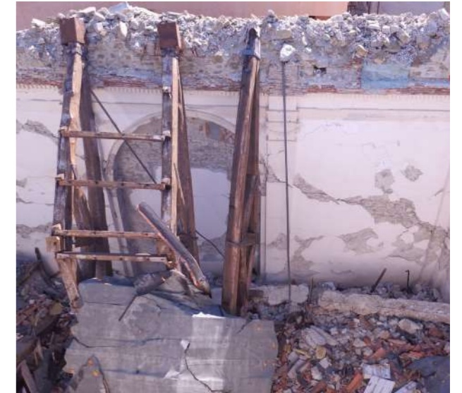
Foto 153 della Protezione Civile: 2018, muratura rimasta, sostenuta da struttura in legno.
