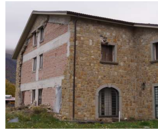
Foto 141 di Martina De Pasquale: 17 novembre 2019, parete di rivestimento in pietra crollata.
