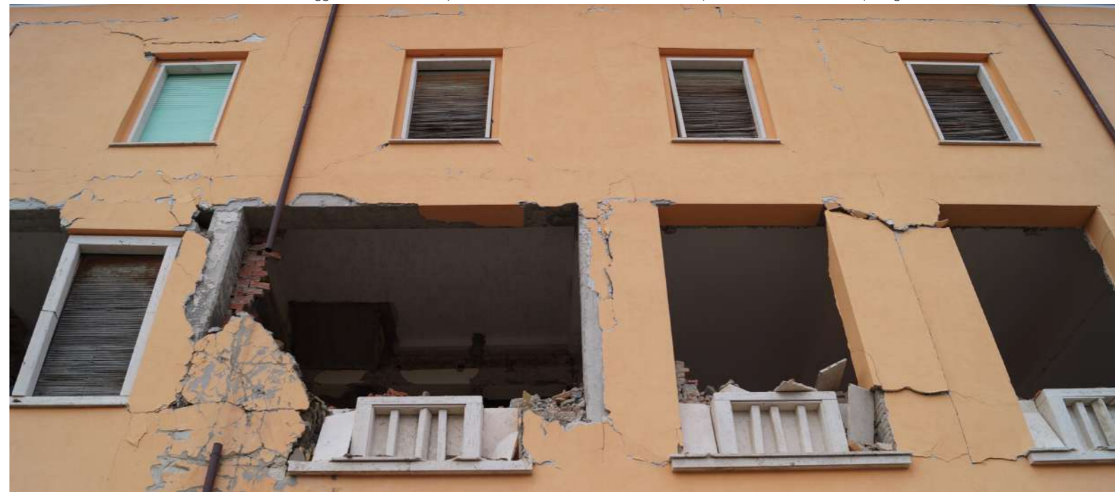
Foto 149 di Elena Zocchi, 06 maggio 2019: crolli tamponamenti in muratura dell'ex Casa di riposo "Don Minozzi" non più agibile.
