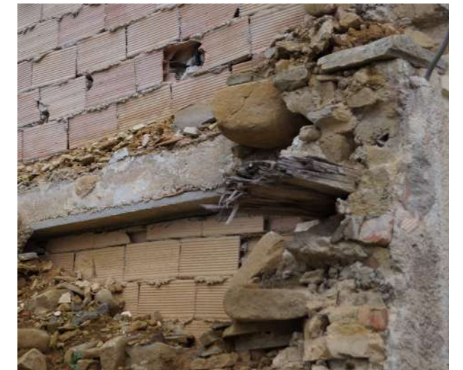
Foto 64 di Martina De Pasquale: 17 novembre 2019, dettaglio costruttivo parete portante e solaio crollati.
