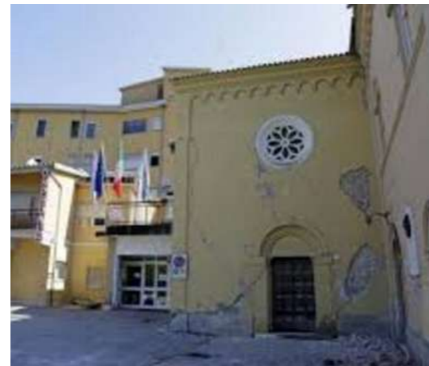
Foto 102: Chiesa S.Giuseppe da Leonessa danneggiata dal sisma (fonte: frontiera di Rieti).
