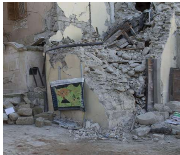
Foto 5 di Emma Moriconi: 15 gennaio 2017, edificio in muratura ad Amatrice. Evidente disgregazione della parete muraria.
