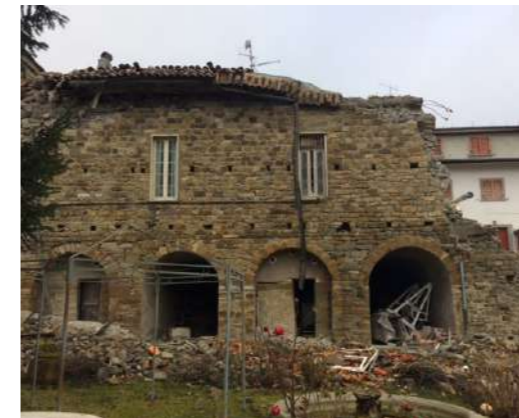
Foto 112 (a sinistra) di Alessandra Tarantino: 2016, edilizia completamente crollata (fonte:ilpost). Foto 113 (in alto) di Emma Moriconi: 12 dicembre 2016, dettaglio edilizia residenziale con aperture ad arco in parte danneggiato. Foto 114 (a destra) di Emma Moriconi: 9 settembre 2016, Porta d'accesso Carbonara (adiacente alla Chiesa Sant'Agostino) crollata dopo le varie scosse.
