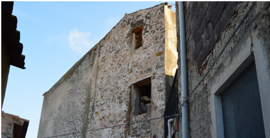
Edificio in stato di rudere
