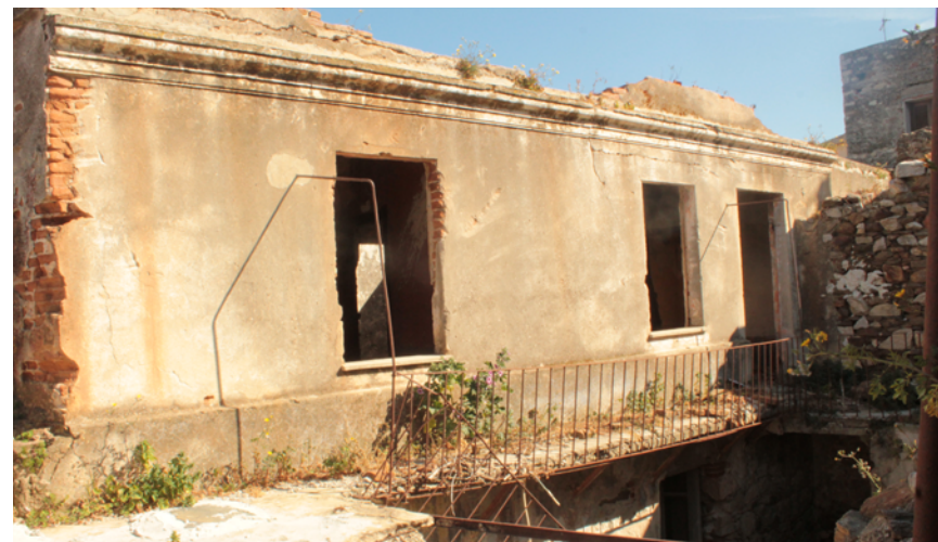
Edificio allo stato di rudere |
