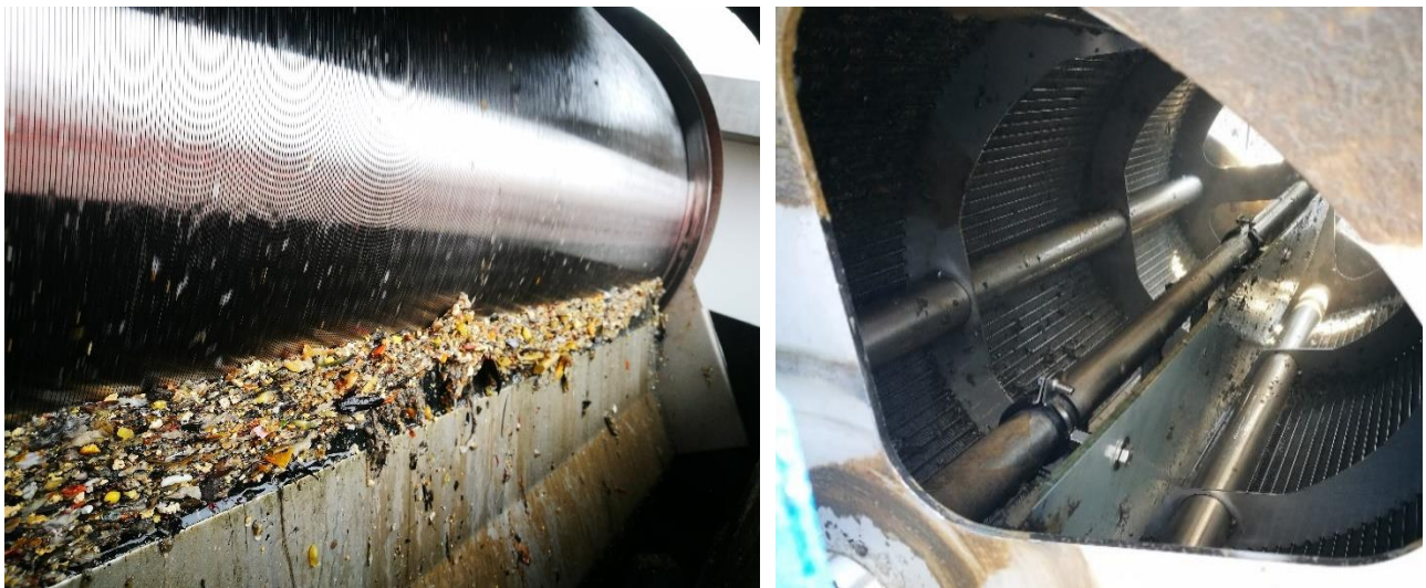
(2): Filtro a tamburo rotante: parte esterna (a sinistra) e parte interna della griglia (a destra).
