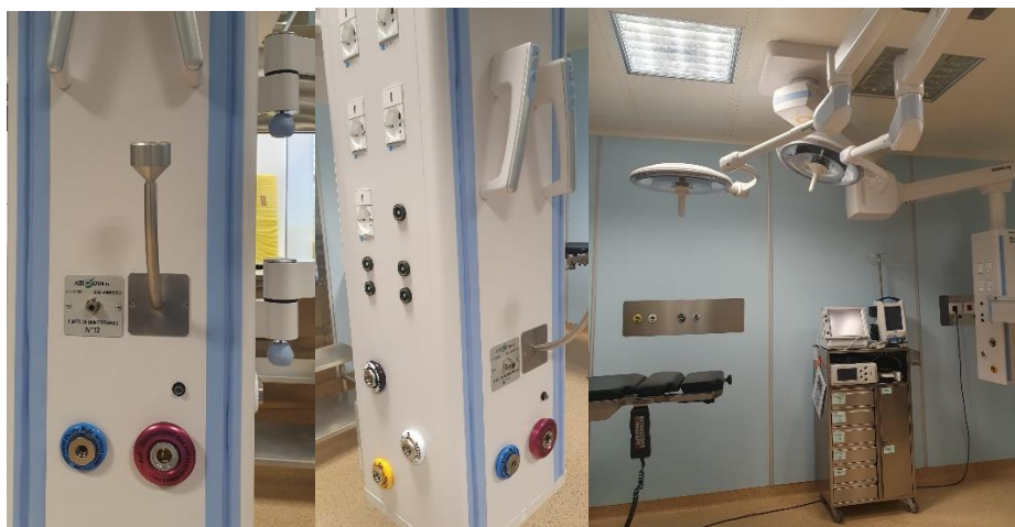
Figura 1.27 (b): Impianto gas medicali sui pensili in sala operatoria
