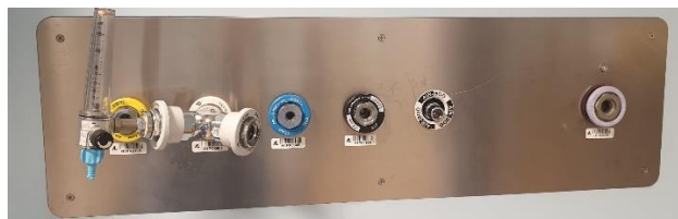
Figura 1.27 (a): Impianto gas medicali sulla parete in sala operatoria
