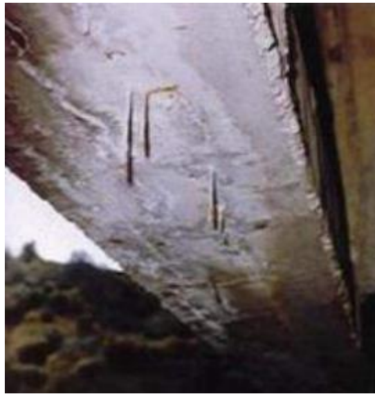
Figura 3.12: Umidità dall'interno, immagine tratta da [14].
