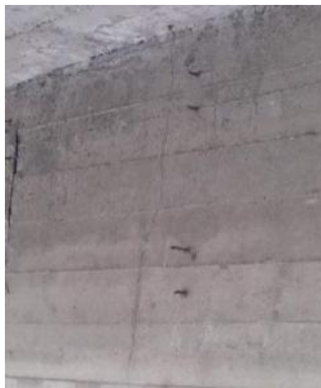
Figura 3.14: Fessure trasversali, immagini tratte da [14].
