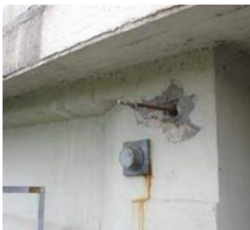
Figura 3.5: Fuoriuscita barre ancoraggio, immagine tratta da [14].
