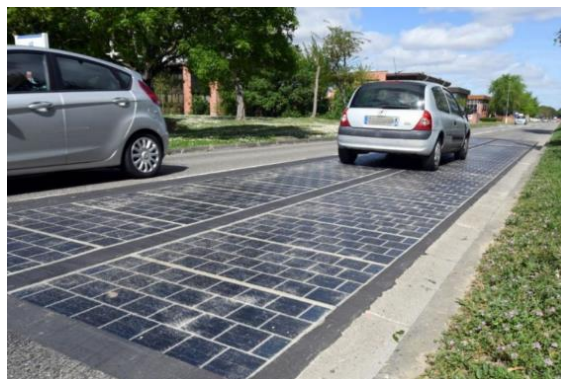
Figura 1.10: Progetto pilota di strada fotovoltaica realizzato a Tourouvre, Francia.
