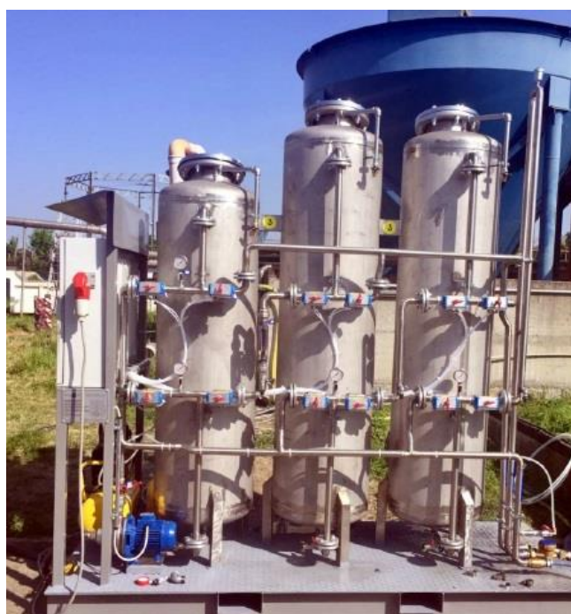
Figura 49: PFAS remover, impianto di Cremona (CR)
