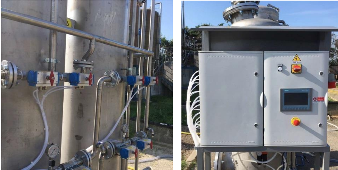
Figura 51: Strumentazione e controllo dell'impianto.
