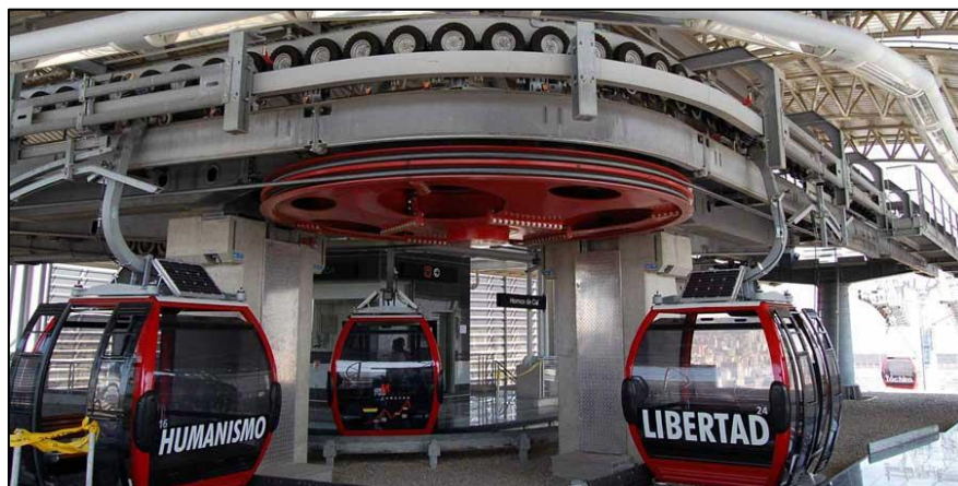
Figura 3.4: Meccanismo all'interno di una stazione di deviazione a Caracas, Venezuela. (The Gondola Project, 2021).
