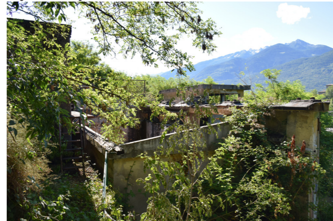
fig. 7.20.9 Esterno, vista sulla cabina di trasformazione, foto nostra
