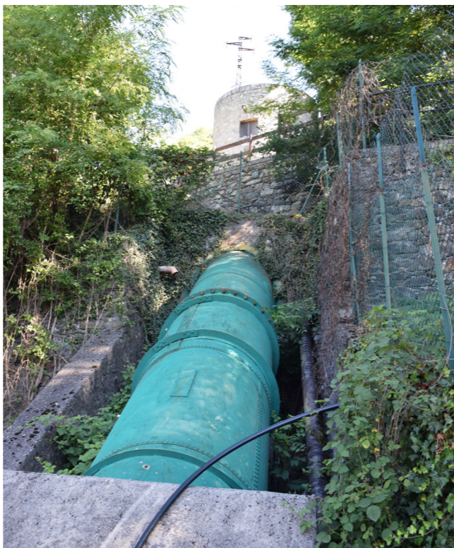
fig. 5.4 Conduttura acquedotto, foto nostra
