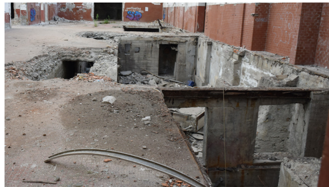
fig. 10.10.2 Vasche di tinteggiatura, Edificio 16, foto nostra
