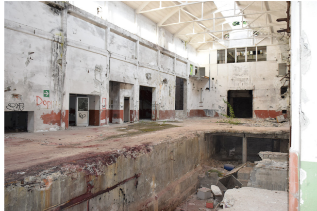
fig. 7.16.4 Interno, vista impianto pozzi, foto nostra
