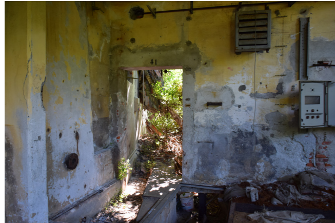
fig. 7.20.4 Cabina di trasformazione, foto nostra
