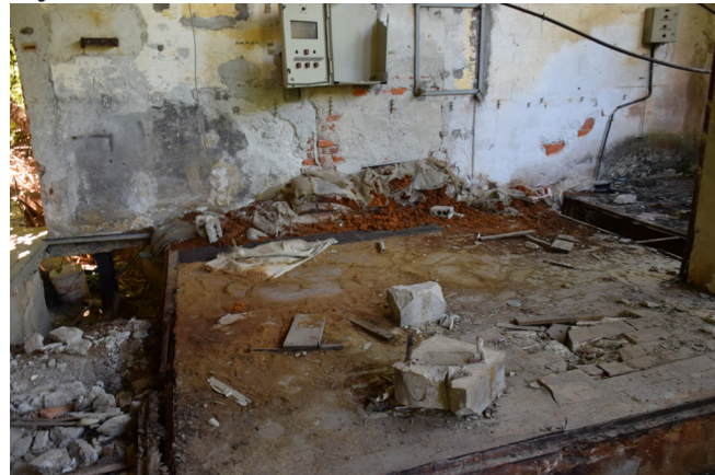
fig. 7.20.6 Cabina di trasformazione, foto nostra
