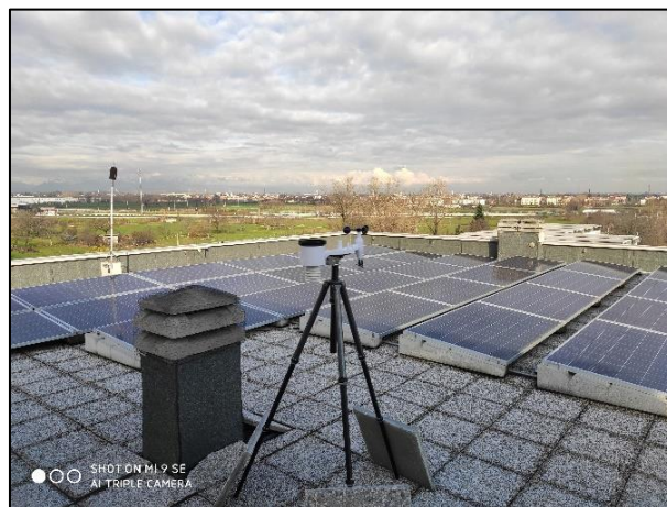
Figura 4.2: Stazione meteo posizionata in sommità dell'edificio in prossimità dei binari per il rilievo dei parametri meteorologici.
