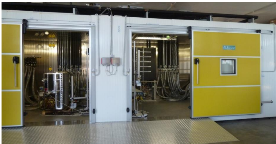
Figura 3.10: Camere climatiche e calorimetro da 20kW a disposizione del laboratorio
