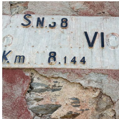
Cartello stradale, mancanza 13 giugno 2026. Fonte: archivio personale
