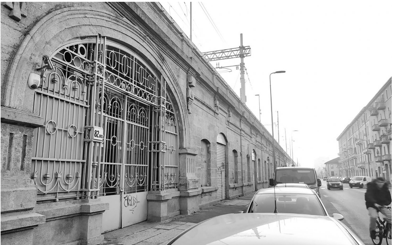
Tavola 20: Situazione attuale all'altezzadel magazzino 82 bis di via Sammartini
