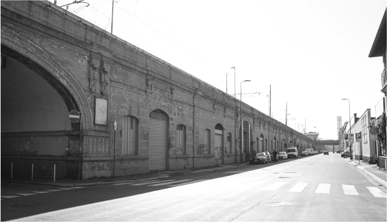
Tavola 18: Situazione antecedente all'intervento: stato di fatto all'altezza dei magazzini 60-62 bis di via Sammartini
